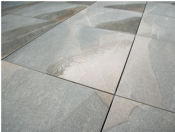
Bild 6: Wasser in Ecken infolge Oberflächenspannung
