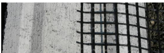
Bild 35: Geogitter auf Böschungsstein
