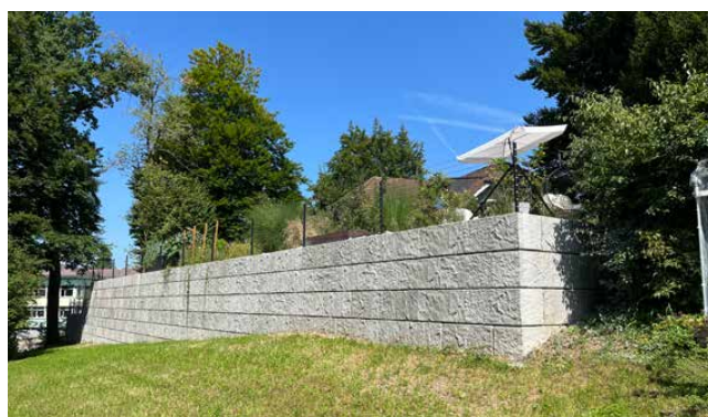
Illustration 26 : garde-corps sur le couronnement d'un mur
