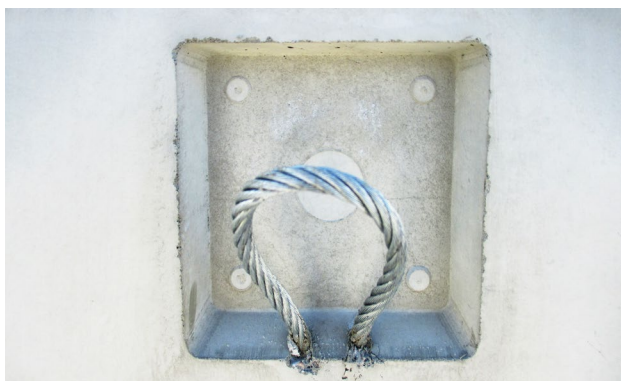
Bild 30: Werkseitig eingebaute Seilschlaufen
