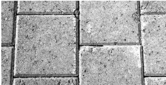
Beispiel von Kantenabplatzungen infolge fehlenden Fugenmaterials
