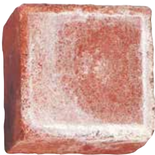
Pflasterstein mit starken Ausblühungen
