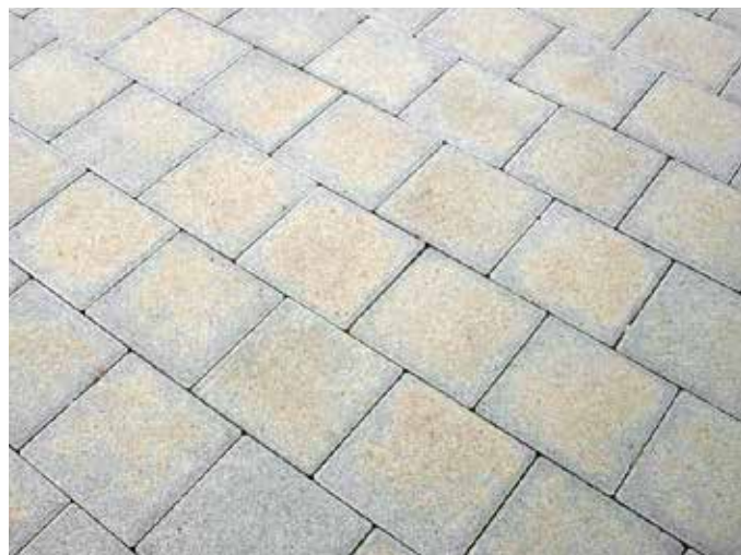
Pflasterstein mit gelb-braun-Verfärbungen
