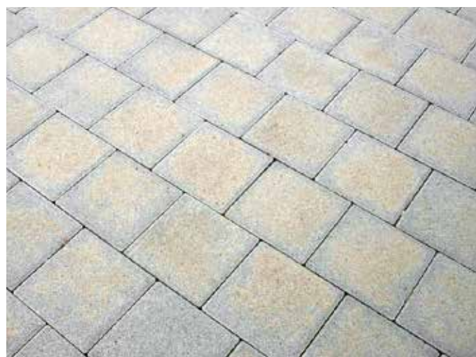
Pflasterstein mit gelb-braun-Verfärbungen
