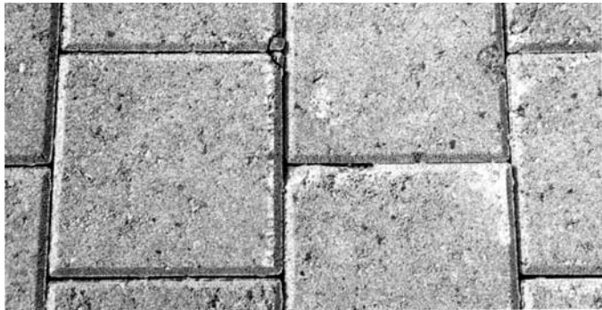
Beispiel von Kantenabplatzungen infolge fehlenden Fugenmaterials
