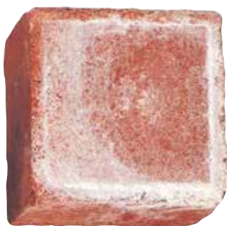
Pflasterstein mit starken Ausblühungen
