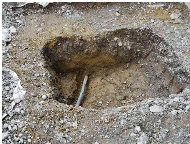
Werkleitungen stören das Wachstum der Baumwurzel
