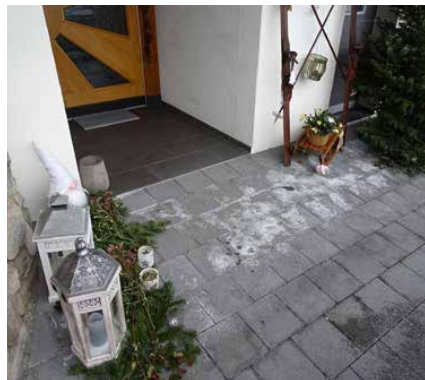
Kalkausblühungen auf jungen Betonpflastersteinen im Eingangsbereich.
