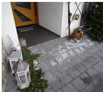
Kalkausblühungen auf jungen Betonpflastersteinen im Eingangsbereich.
