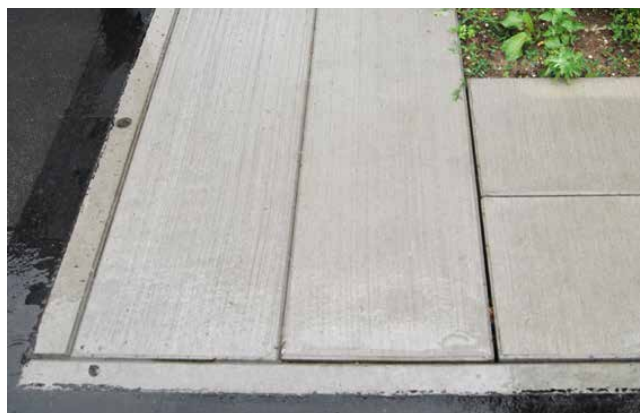
Wasserzufuhr durch Fugen
