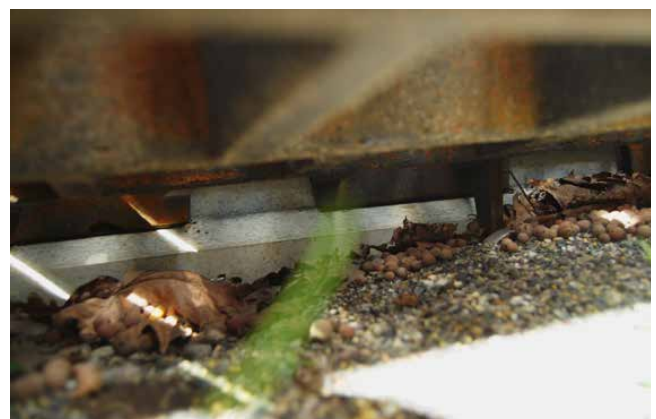
Genügender Zwischenraum unter der Abdeckung
