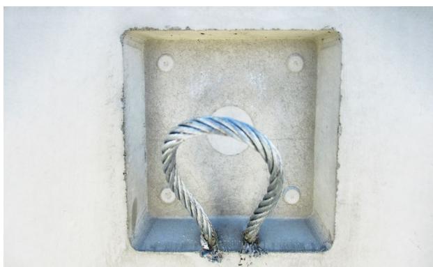
Bild 18: Werkseitig eingebaute Seilschnlaufen
