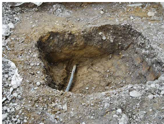
Werkleitungen stören das Wachstum der Baumwurzel
