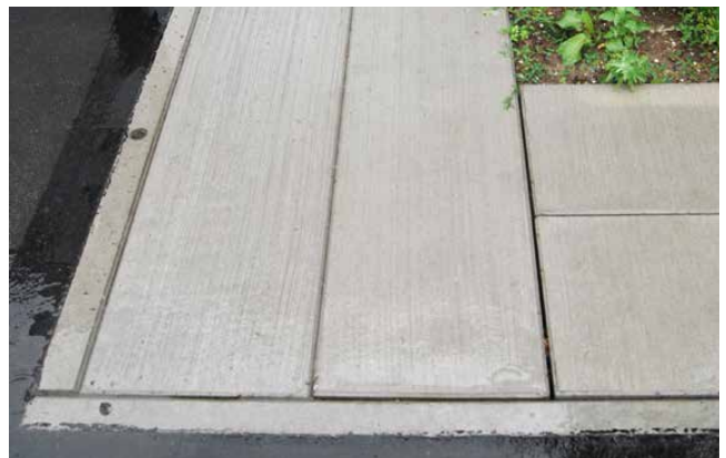
Wasserzufuhr durch Fugen
