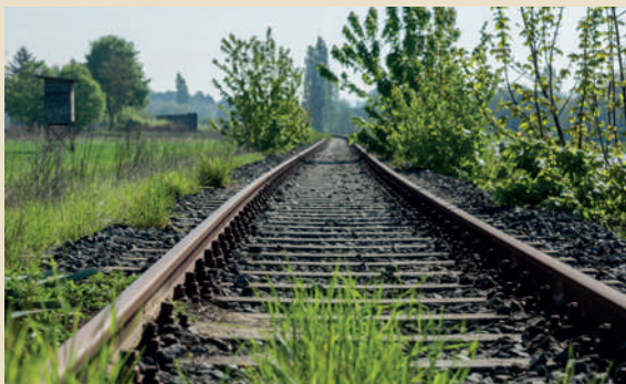
Bahngleis mit Bewuchs
