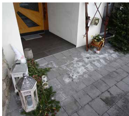
Kalkausblühungen auf jungen Betonpflastersteinen im Eingangsbereich.
