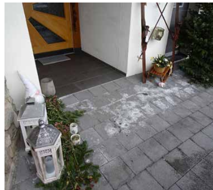
Kalkausblühungen auf jungen Betonpflastersteinen im Eingangsbereich.
