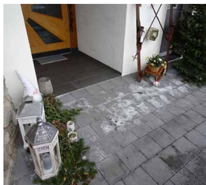
Kalkausblühungen auf jungen Betonpflastersteinen im Eingangsbereich.
